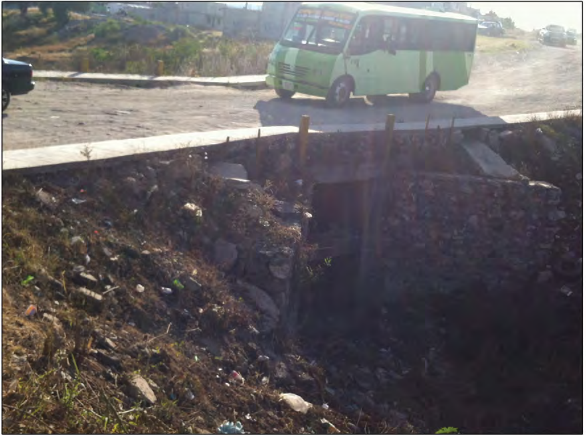
Puente que se hizo en Sta. Catarina Junta Aux. de San Fco. Totimehuacan
